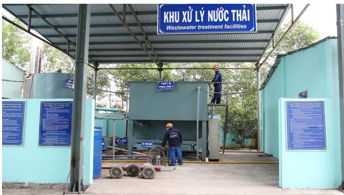
Hệ thống xử lý nước thải và chất lỏng thải – 50 m 3 /ngày đêm
